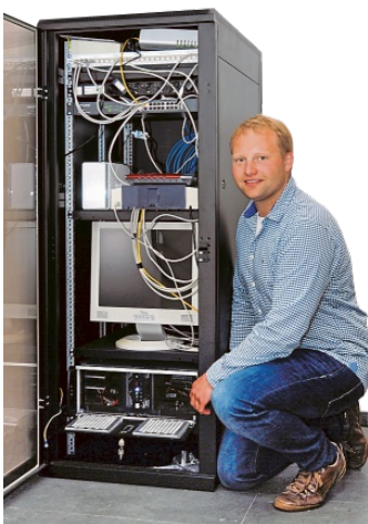
Der Server steht in einem fensterlosen Raum in der Mitte des Gebäudes.
